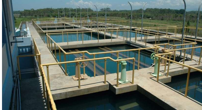
Tanques de tratamento de água
